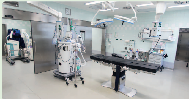
Operationssaal in der Zentralen Notaufnahme des EKW
